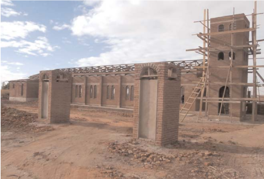
Ο Ναός των Αγίων Κωνσταντίνου και Ελένης κατά τη διάρκεια της κατασκευής του
