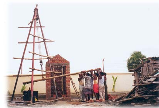
Ἐνοικία γεωτρήσεως στό χώρο τοῦ ὀρφανοτροφείου θηλέων στήν Καλκούτα Ἰνδίας
